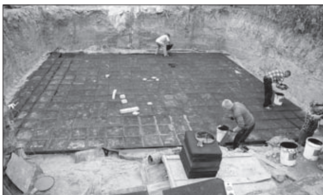
Фото 1. Утеплювати пасивні будівлі слід з усіх сторін, в тому числі і під фундаментом. 100 мм - шар утеплювача укладається під фундаментну подушку будівлі.
