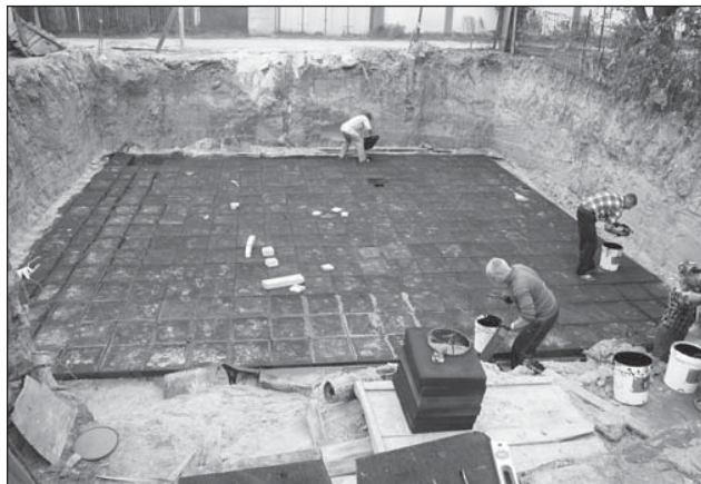
Утеплення першої української пасивної будівлі знизу, під фундаментною подушкою. Архітектор Тетяна Ернст
