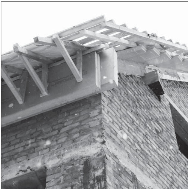
Утеплення даху першого пасивного будинку в Києві (арх.Т.Ернст) екструдованим пінополістиролом (між стропилами і по стропилах)
